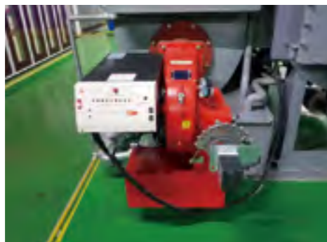
대기오염저감 보일러 저녹스 버너 설치
