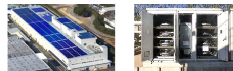
岡崎製作所(愛知県)に設置した太陽光発電設備および蓄電システム
