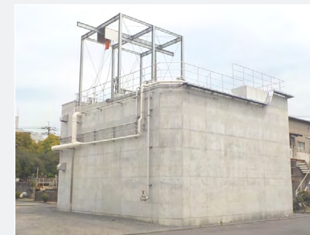
し尿・生活系排水処理施設 (水島製作所)
