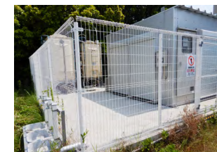
地下水膜ろ過設備（岡崎製作所）
