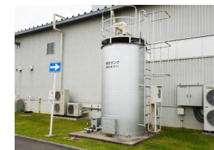
雨水貯留タンク（岡崎製作所）
