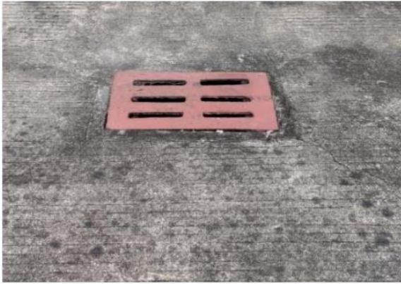
(图 雨水下水道)
