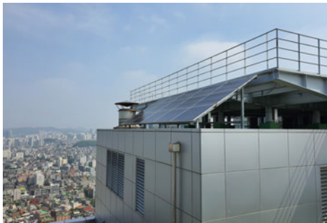
[KB손해보험 합정사옥 태양광 발전설비]
