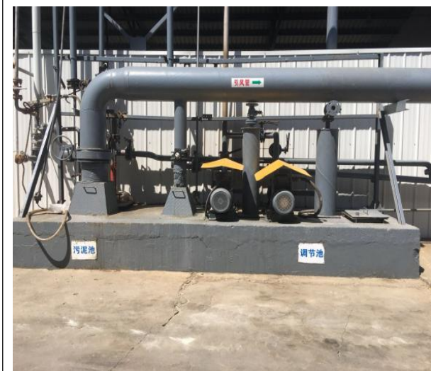
调节池及污泥池
