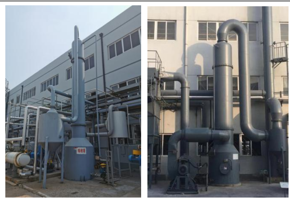
车间废气水喷淋过滤塔
