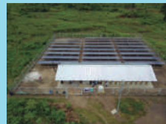
Central de generación fotovoltaica de 109,35 kWp en la localidad de Chorrobocón, Guainía. Usuarios atendidos: 189
