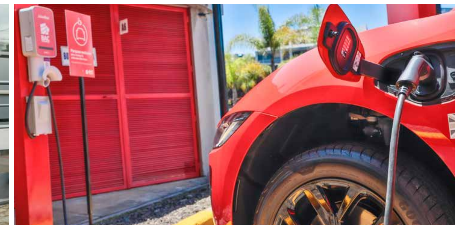
Cargador eléctrico para vehículos, Costa Rica, 2021
