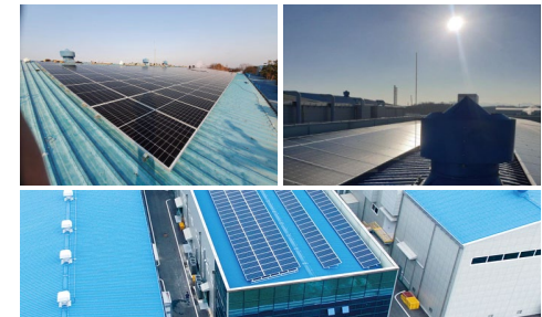
1, 3공장 태양광 발전소
