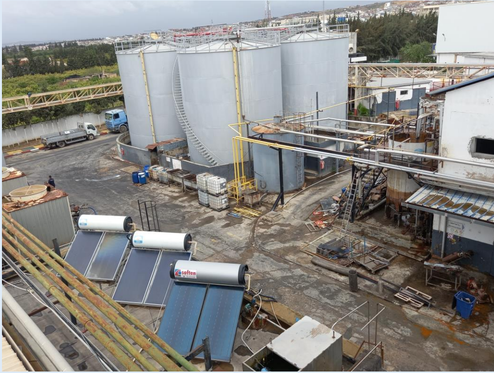
Investissement en énergie renouvelable (panneaux solaires) pour l'eau chaude des blocs sociaux– Juin 2021
