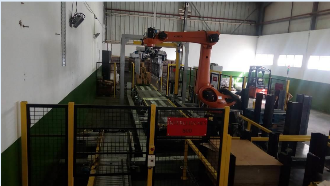
Installation d'un robot en fin de chaine de conditionnement avril 2018
