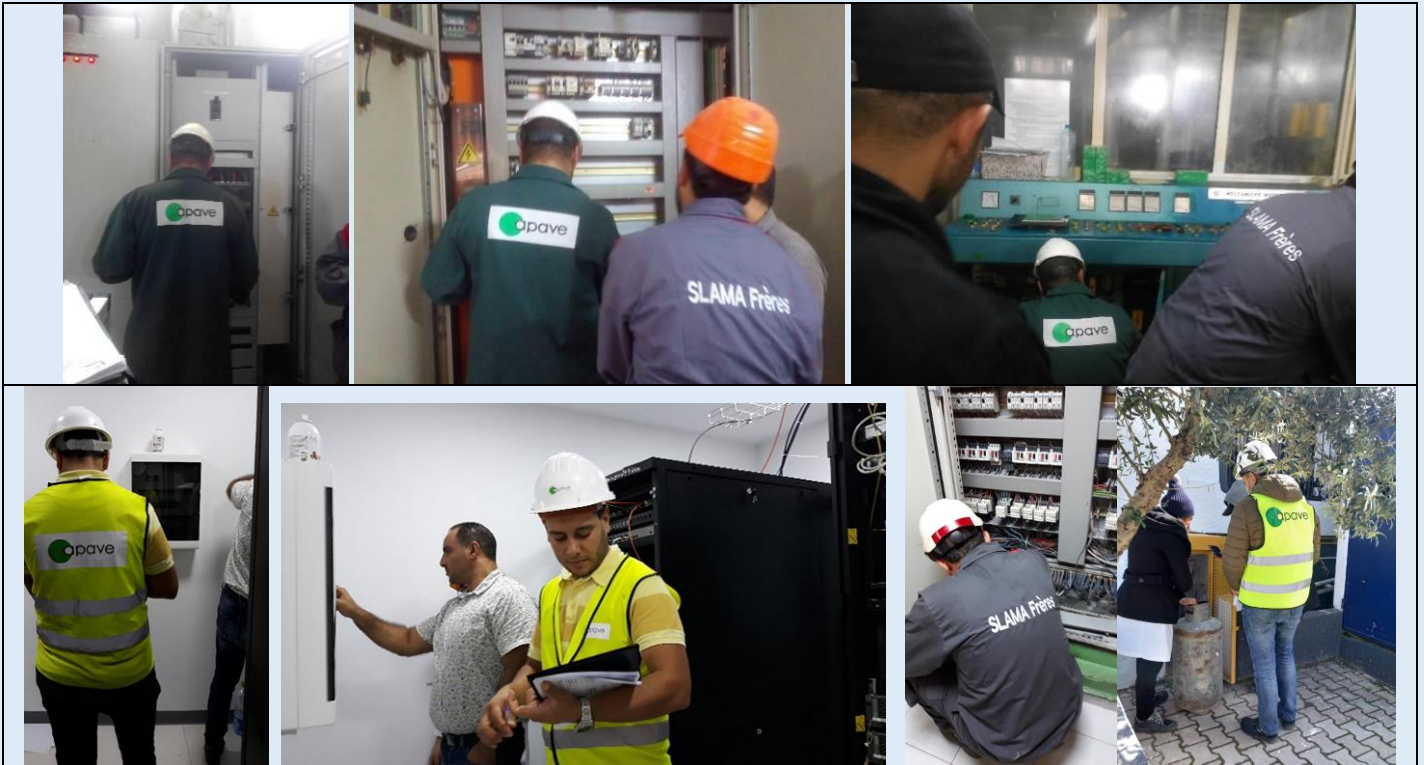
Visite semestrielle de contrôle de l'état des installations électriques par l'apave.
