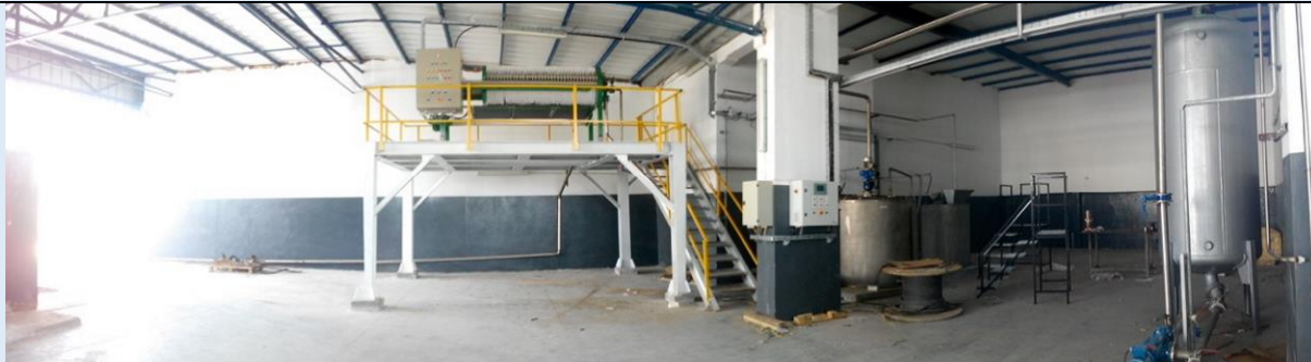
Sludge processing unit - Unité de traitement de boue lancée en 1 er avril 2016 – inaugurée en 19 mai 2016 par le ministre de l’environnement et développement Durable Monsieur Néjib Derouich. On 1st april 2016, We commissioning the new sludge drying system with filter press of the Wastewater Treatment Plant (WWTP)
