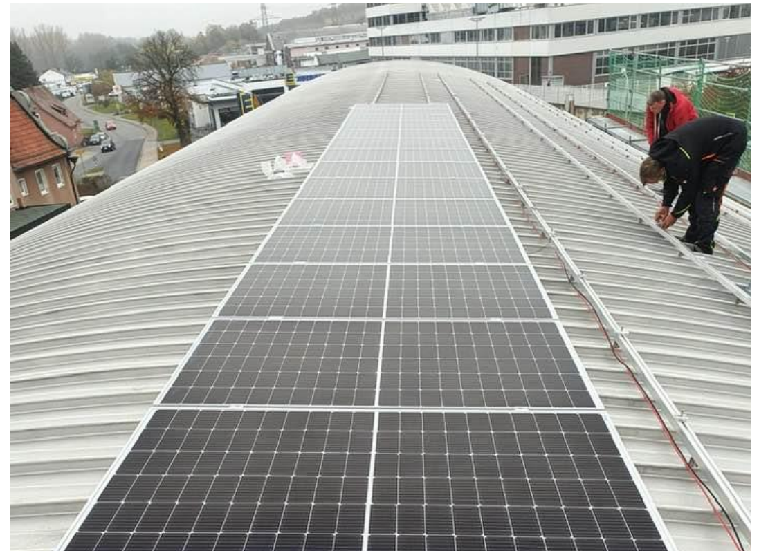
Die Installation der Photovoltaikanlage bei marcapo hat begonnen. Bald erzeugen wir unseren Strom nahezu komplett selbst.
