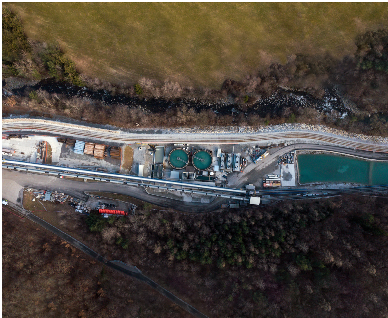
Figura 13: Vista aerea dell'impianto di trattamento delle acque presso il cantiere di Unterplattner
