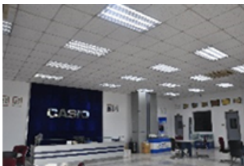
カシオ電子科技(中山)ロビーのLED照明
