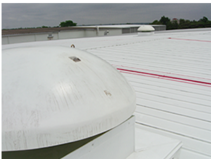
廃熱用電動ルーフファン
