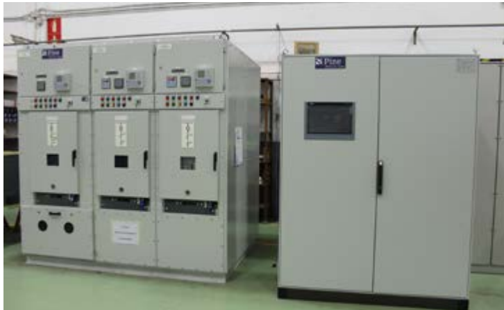
Cuadro eléctrico Acerinox
