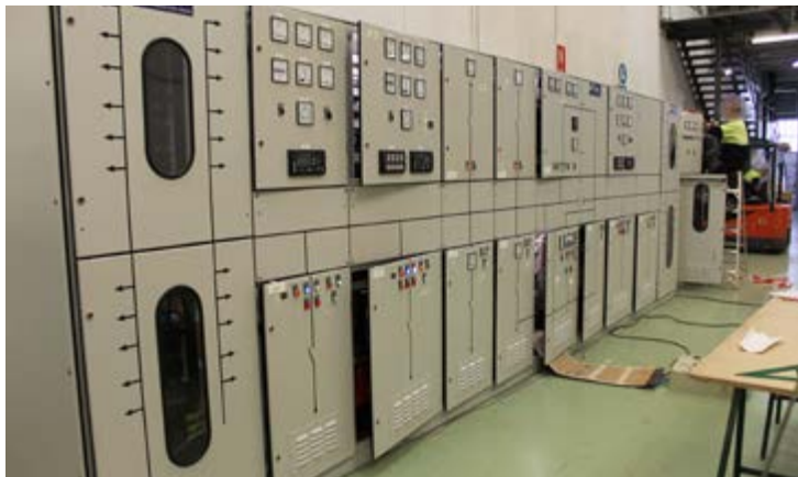
Cuadro eléctrico Balenciaga
