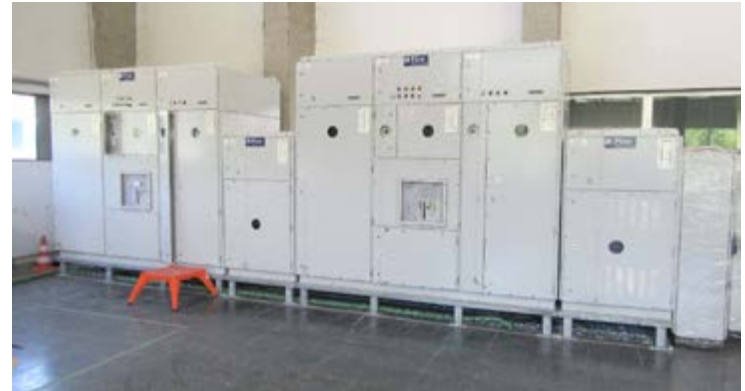
Cuadro eléctrico Acciona Javierrelatre
