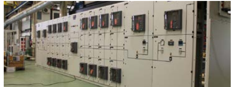
Cuadro eléctrico Iberdrola Daivoes
