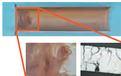
腐食解析一例(配管抜き取り調査)
