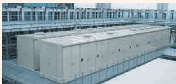
屋上キュービクル
