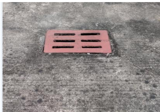
(图 雨水下水道)
