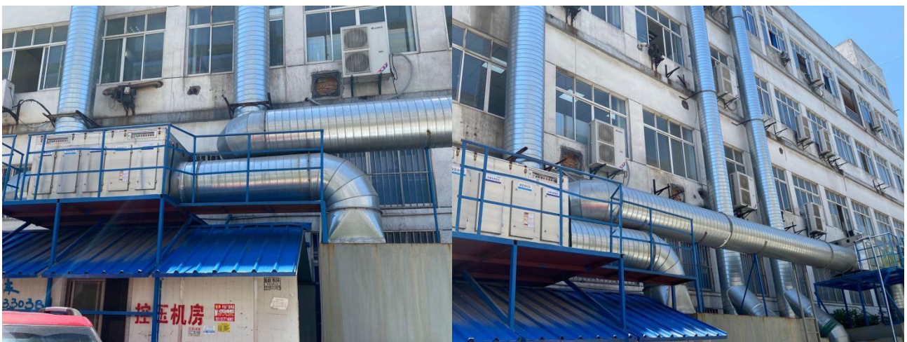
废气收集处理系统
