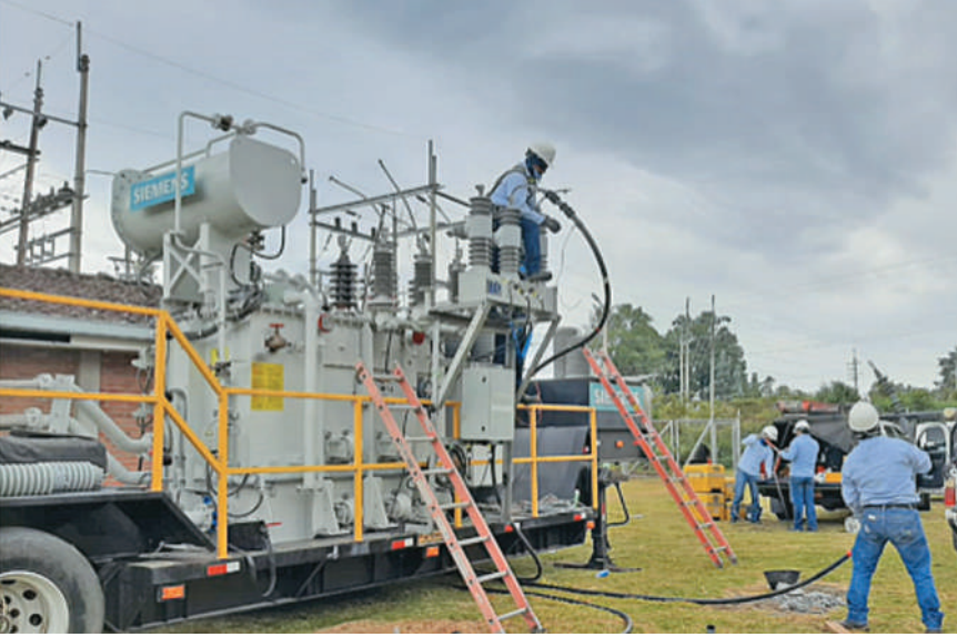
Instalación y puesta en servicio de la subestación móvil para realizar trabajos previos a la instalación del nuevo transformador de potencia de la subestación Silvia.
