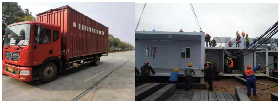
火神山、雷神山医院通信基础设施部署现场
