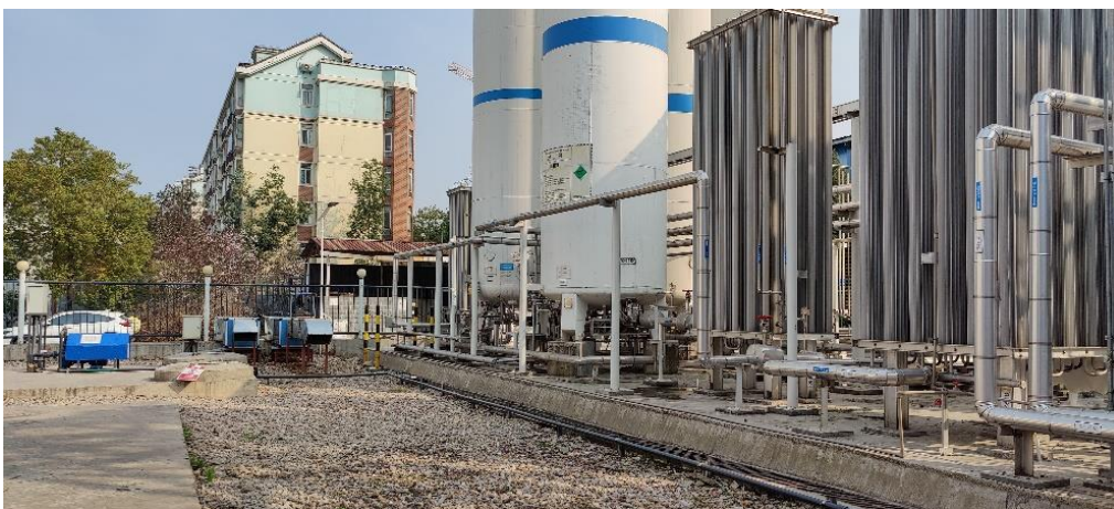
气化器喷淋水收集装置
