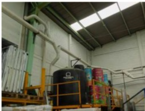
Desvío a drenaje y válvula de seguridad
