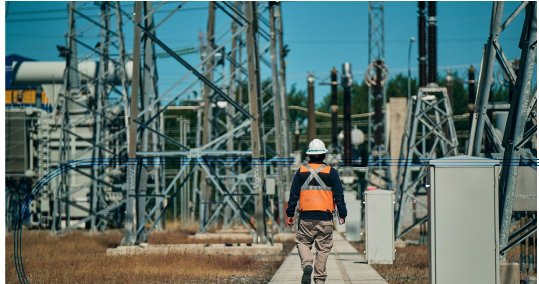
SUBESTACIÓN CHARRÚA (CHILE)
