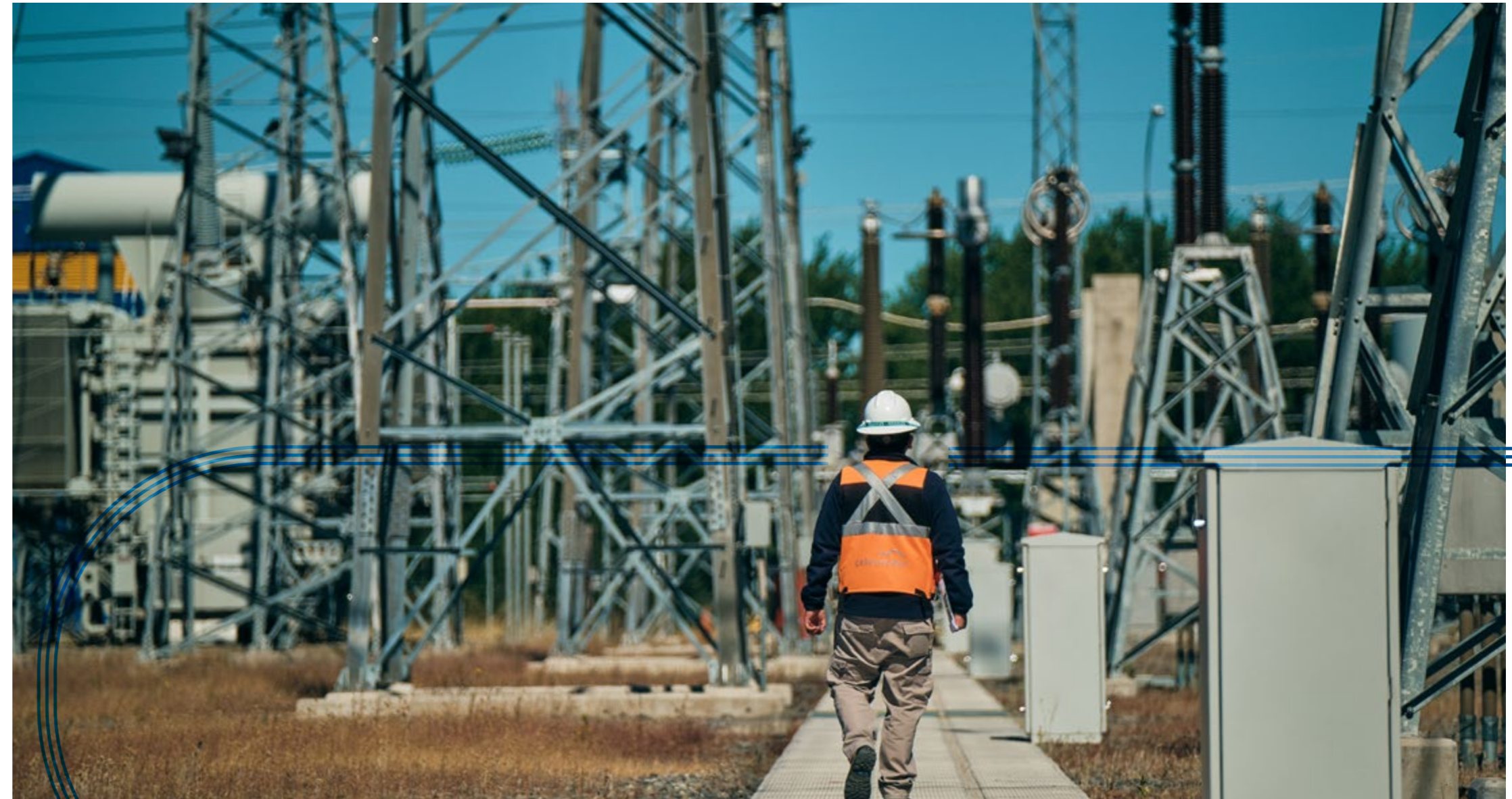
SUBESTAÇÃO CHARRÚA (CHILE)
