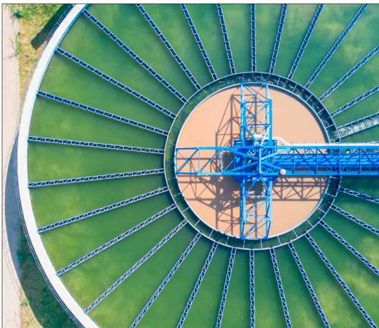
Planta potabilizadora de agua fabricada con componentes de acero inoxidable.
