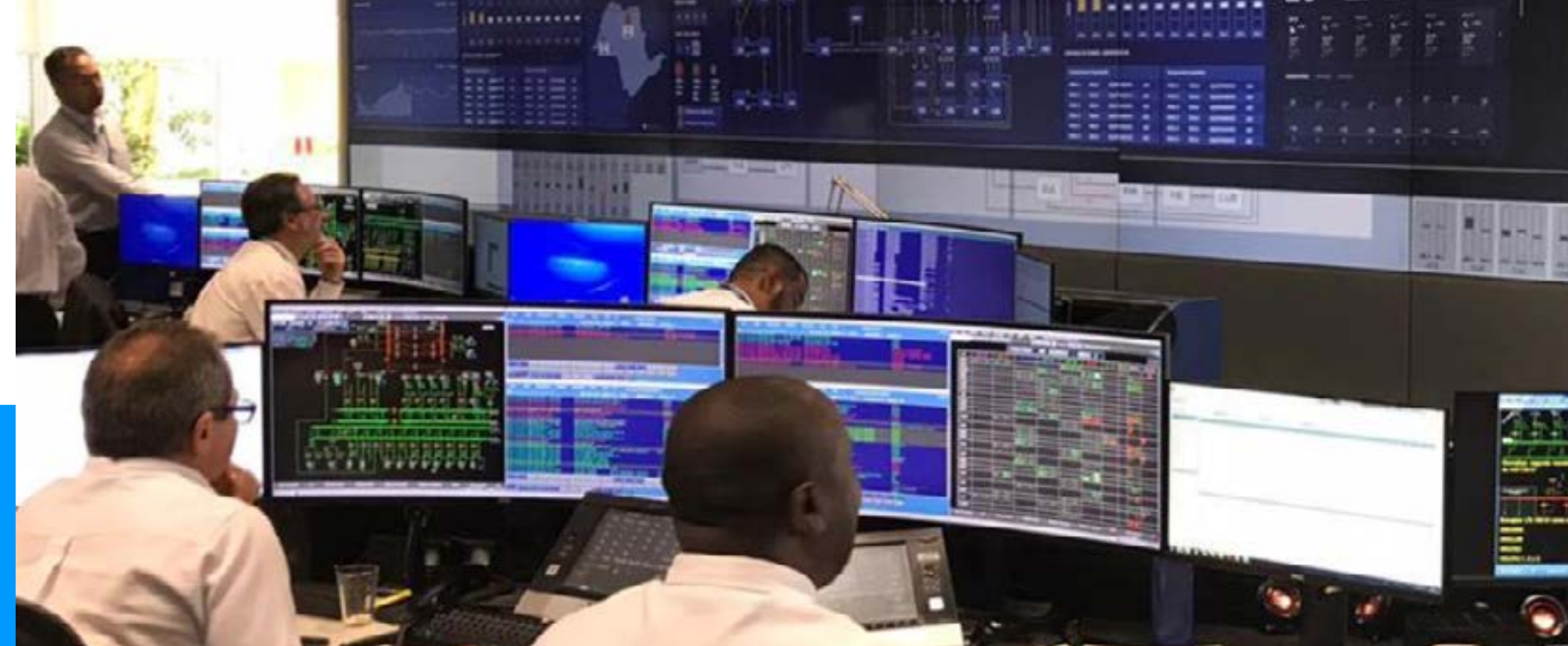
CENTRO DE OPERAÇÃO DE TRANSMISSÃO (COT), EM JUNDIAÍ (SP)
