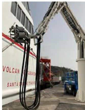
Instalación eléctrica de la Gómera
