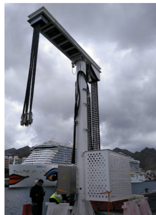
Instalación eléctrica de suministro a buques en los muelles Ribera I
