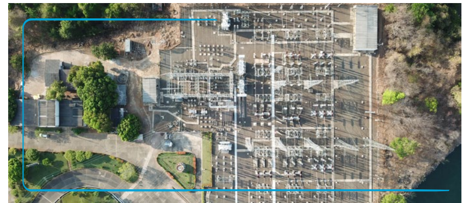
Boa Esperança Substation in Piauí. Credit: Sudene Drone.
