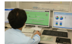
福岡工場のエネルギー監視システム
