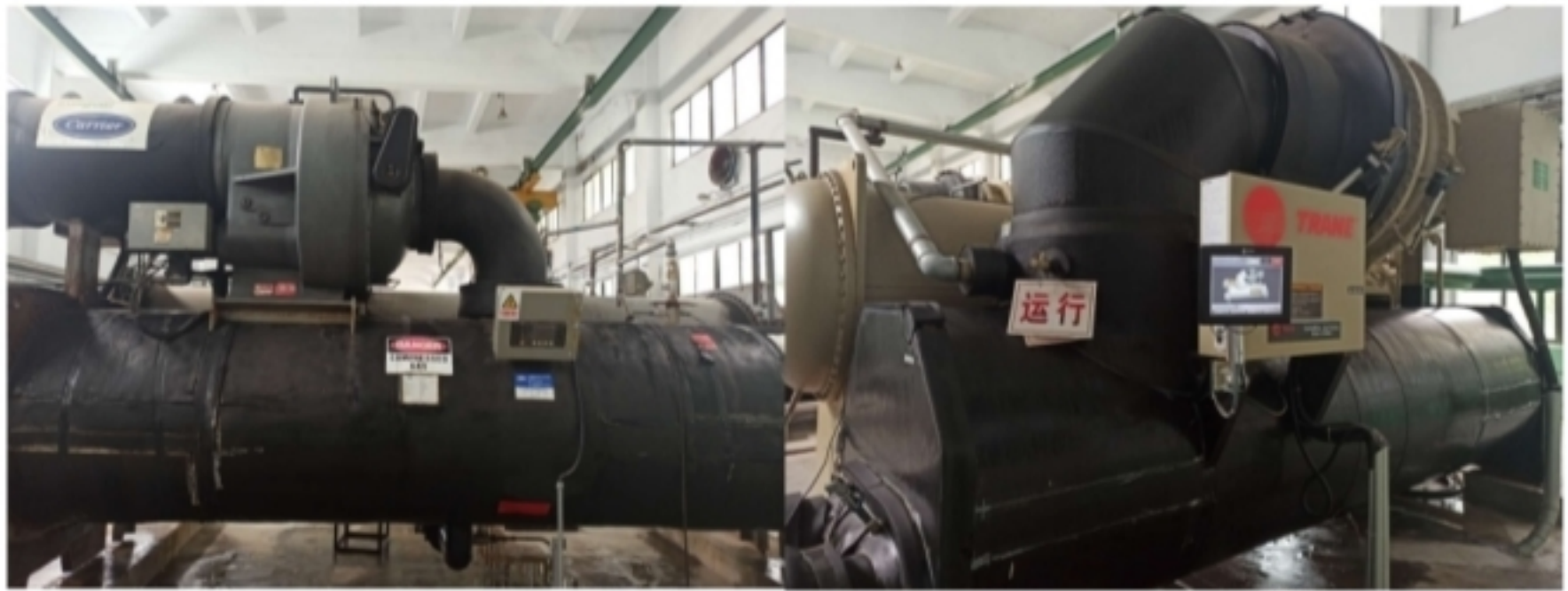
开利冷冻机（5 台）
