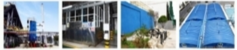
低氮燃烧改造 ( \text{NO}_x : \leq 50\text{mg}/\text{m}^3 ) 无组织排放收集 (收集处理) 排污口美化 (废物利用) 污水池加盖收集处理 (达标排放)
