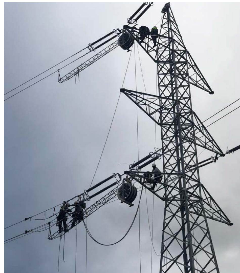
Subestaciones y líneas de transmisión asociadas de cuatro parques eólicos de ENEL Green Power Iberia.
