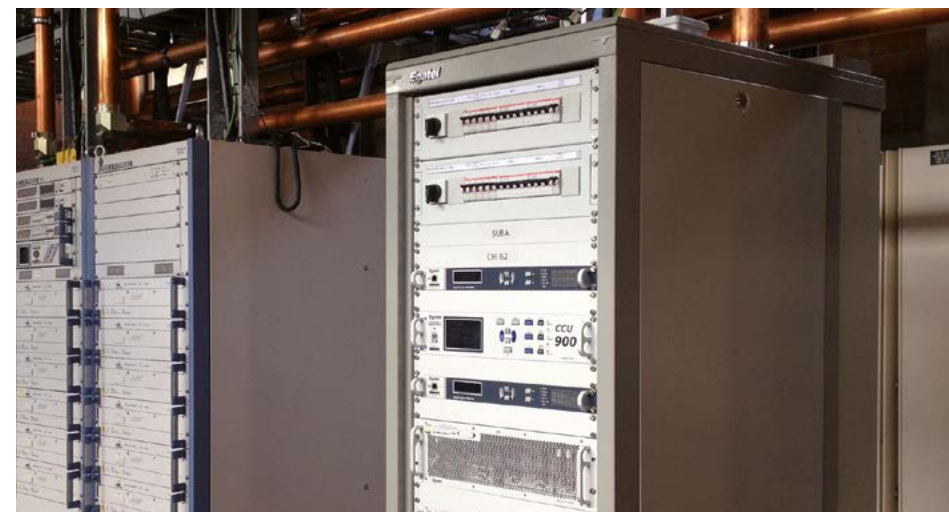
Transmisor de telecomunicaciones de Egatel (Colombia).
