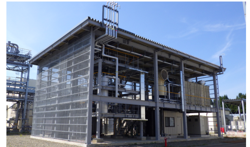
CO 2 -メタネーション試験設備
