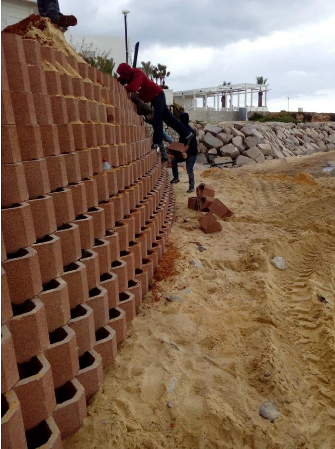
Travaux de protection frontale de la falaise de l'Hôtel le SULTAN à Hammamet
