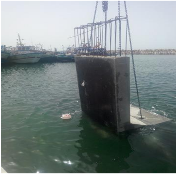
Travaux de réparation du quai endommagé au port de pêche de Sidi Daoued
