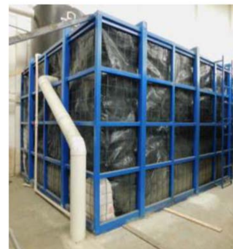
Cisterna (Depósito principal)
