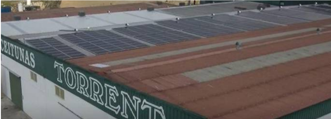
Placas solares en la cubierta de las instalaciones de Aceitunas Torrent
