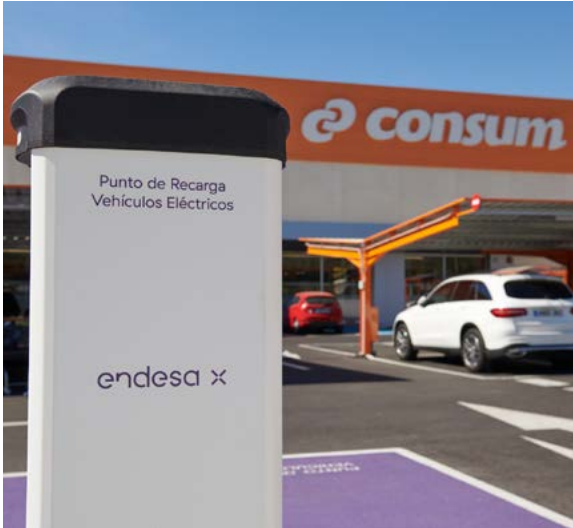
Punto de recarga para coches eléctricos
