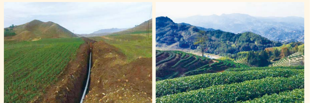
在内蒙古自治区武川县大路壕村实施水利帮扶项目,满足当地农作物种植的用水需求,为农田耕作提供长效保障
