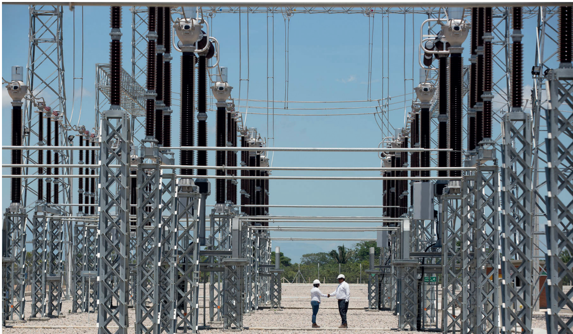
Nuestras subestaciones cuentan con tecnología de punta que permite elevar la calidad de la prestación del servicio
