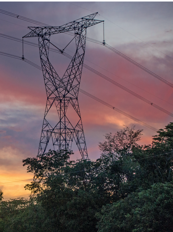
Torre en el corregimiento de La loma, Cesar
