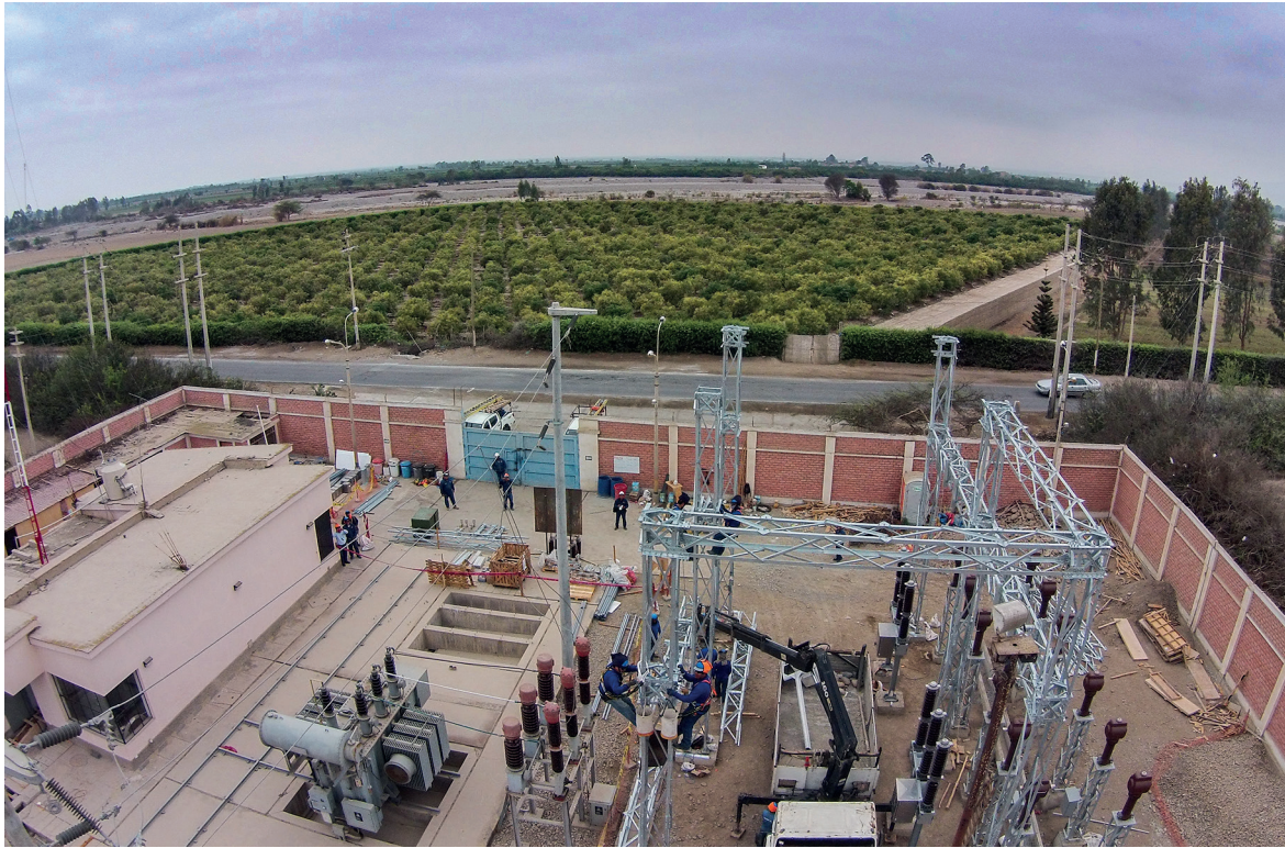
Infraestructura de Electro Dunas en Perú
