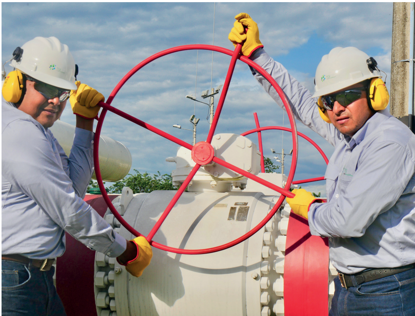
Colaboradores de TGI en la estación de compresión de gas en Mariquita (Tolima)
