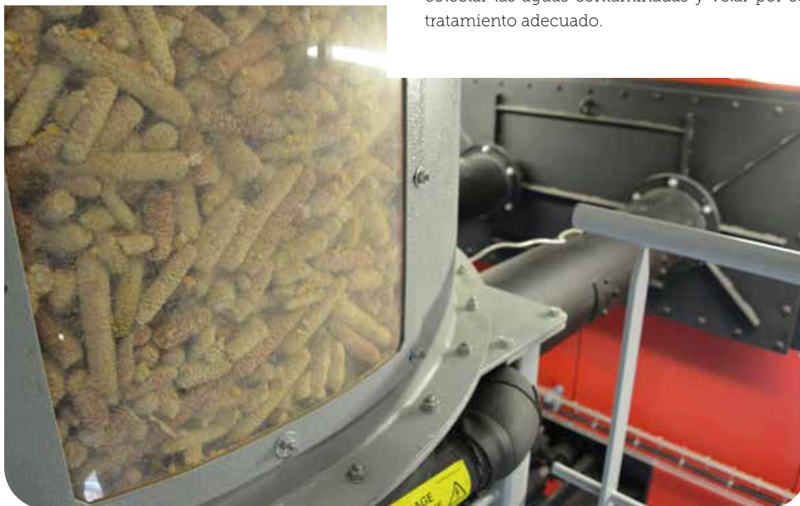
Limagrain Ingredients: caldera instalada en la planta de Ennezat (Francia) para valorizar las mazorcas de maíz provenientes de la producción de semillas de Limagrain Coop, transformándolas en energía
