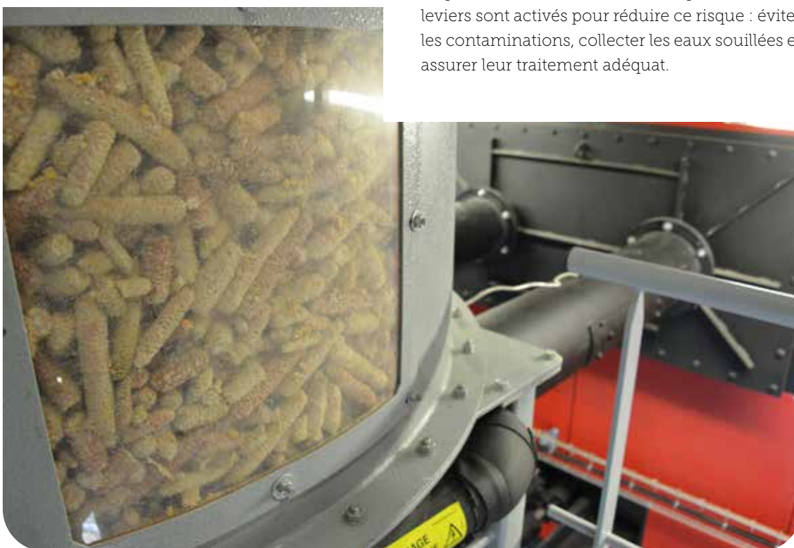
Limagrain Ingrédients : chaudière installée sur le site d'Ennezat (France) valorisant en énergie les rafles de maïs provenant de la production de semences de Limagrain Coop.
