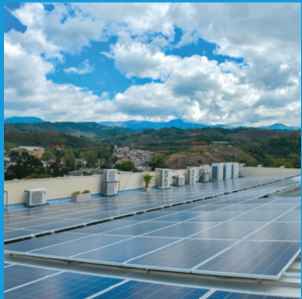
Proyecto solar CDM Transformadores
