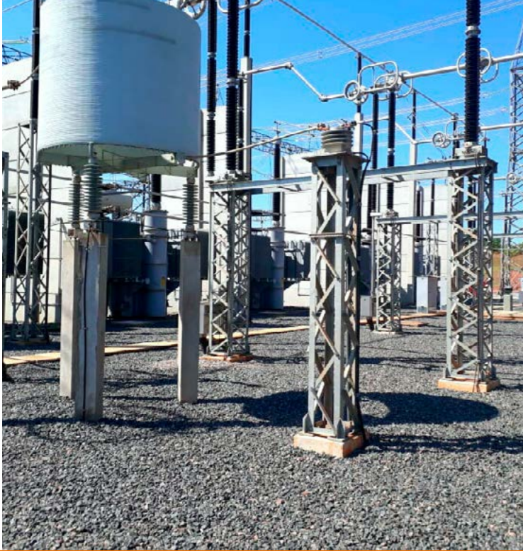
Subestação Fernão Dias - Cantareira Transmissora de Energia
