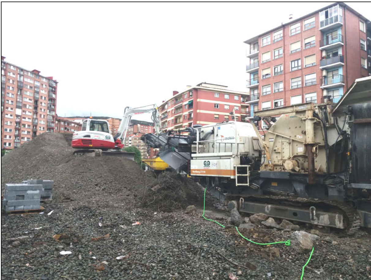
Obtención de árido reciclado con planta machacadora móvil. Materia prima: hormigón demolido. Obra: Urbanización del futuro parque de Pozokoetxe. Promotor: Ayuntamiento de Basauri (Bizkaia).
