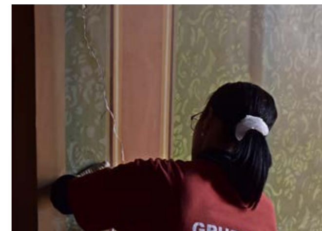
Obras de revitalização do Prédio Rosa, no Salão Nobre, em agosto de 2018
