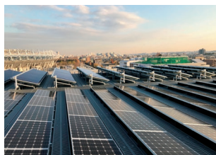
武蔵野の森総合スポーツプラザの太陽熱利用設備・太陽光パネル
