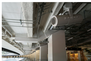
写真提供：独立行政法人日本スポーツ振興センター 気流創出ファン
