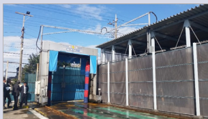
中古購入した洗車設備
