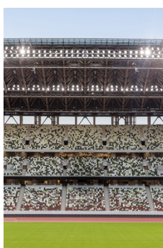
写真提供：独立行政法人日本スポーツ振興センター 競技用照明（LED）
