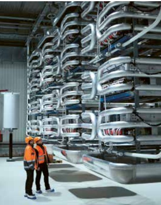
In der Konverterhalle in Bentwisch.
