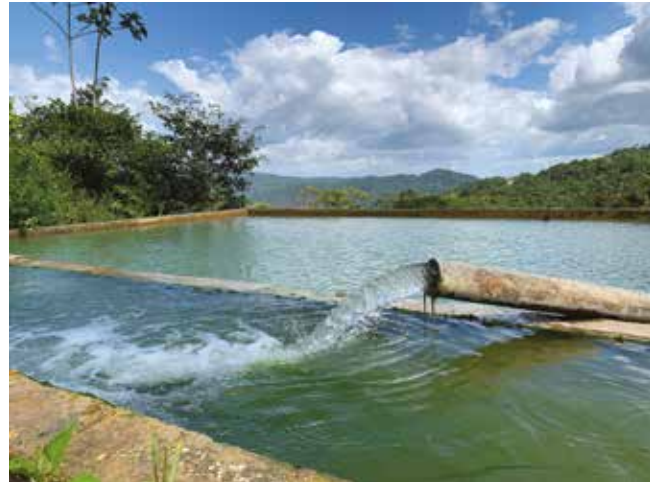
Sistema de tratamiento y recirculación aguas mina Grupo Panamá. Nicaragua
