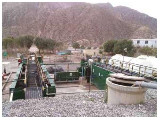
Sistema de tratamiento de efluentes cloacales. Argentina
