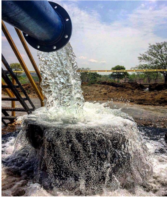
Acueducto Pozo 51 - Sincelejo, Sucre
