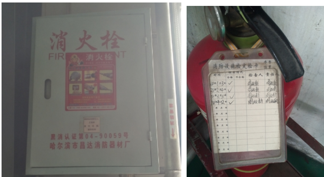
工厂内的消防设施及定期检查登记卡
