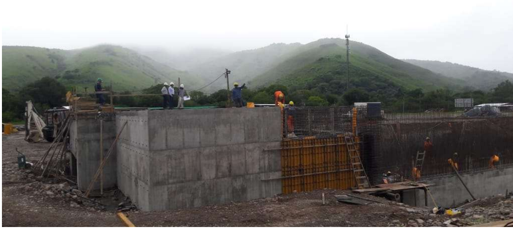
Planta Potabilizadora en Dique Campo Alegre y Acueducto – Salta
