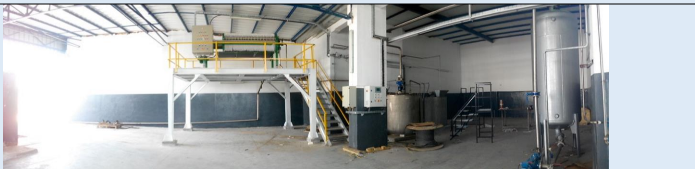
Sludge processing unit -Unité de traitement de boue lancée en 1 er avril 2016 – inaugurée en 19 mai 2016 par le ministre de l'environnement et développement Durable Monsieur Néjib Derouich. On 1st april 2016, We commissioning the new sludge drying system with filter press of the Wastewater Treatment Plant (WWTP)
