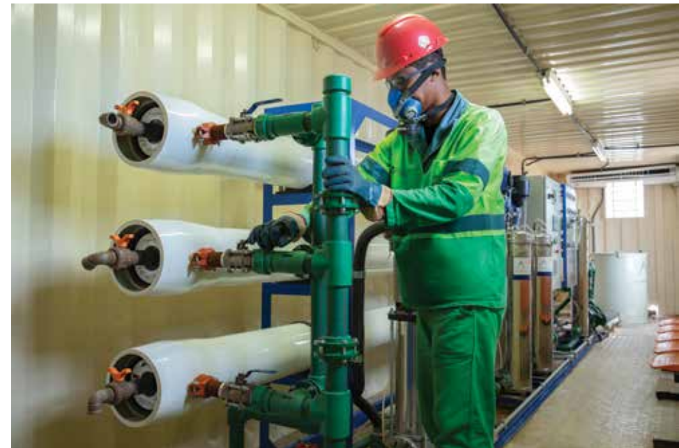
Profissional trabalha na Estação de Tratamento de Efluentes em Maceió (AL)
